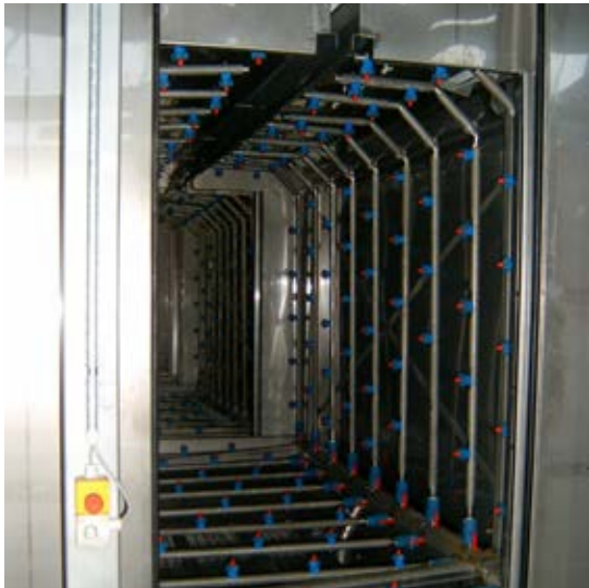
Anlage zur chemischen Vorbehandlung
