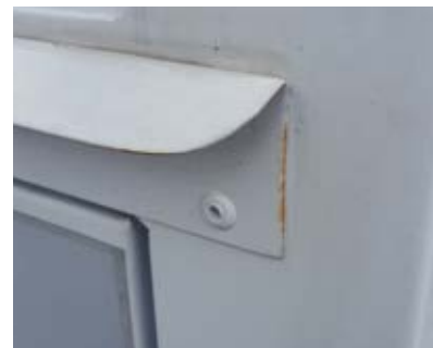
Schadensbild durch zu geringe Schichtstärke an der Kante
