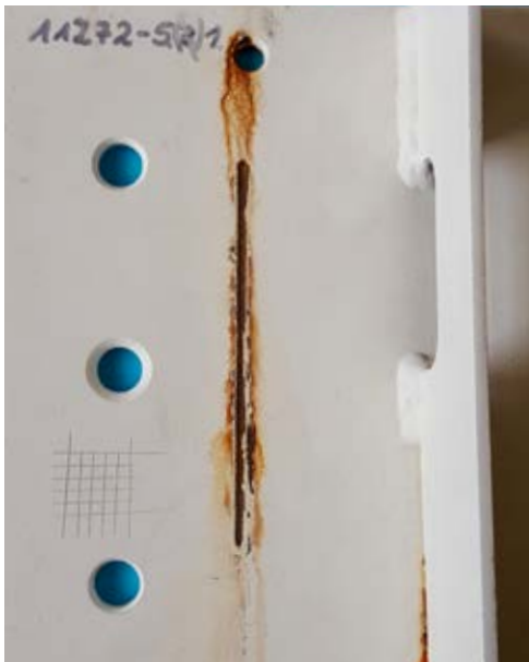
Abbildung 20: Detailansicht einer Probe, die die aktuell gültigen Normanforderungen einer C5 Korrosivitätskategorie erfüllt. Im Spalt sichtbare Korrosion könnte noch durch eine zusätzliche Abdichtung vermieden werden
