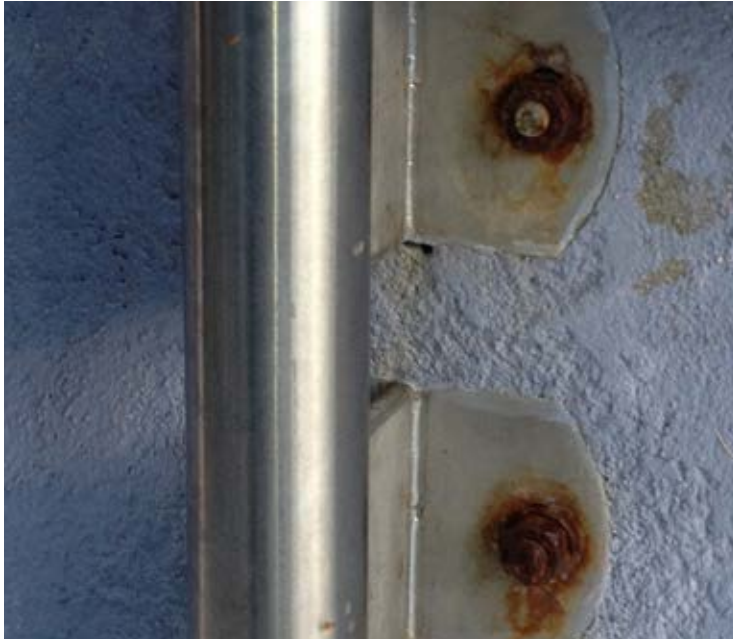
Abbildung 3: Beispiel für Kontaktkorrosion, Edelstahlgeländer verzinkter Verschraubung
