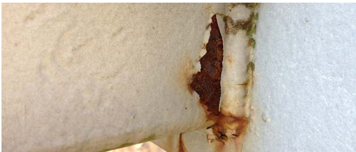
Abbildung 13: Beschichtungsschäden an einer nicht ordentlich gereinigten Schweißnaht
